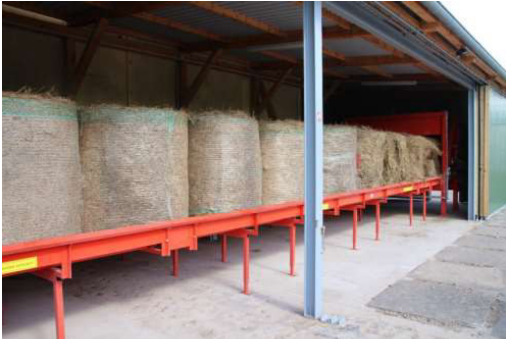
Abbildung 4: Förderband und Ballenauflöser. Die Länge des Förderbandes bestimmt die Brennstoffbevorratung. Heizwerk Malchin. Foto. C. Schröder
